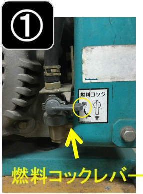
燃料コックレバーが「閉」になっています
